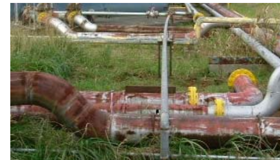
外面が錆びた危険物配管
